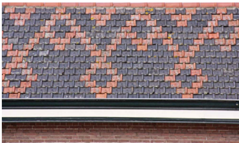
Praktijkvoorbeeld van creatief gebruik van kleine hoeveelheden recuperatiepannen: combinatie met andere pannen (andere kleur). Loods bij het station van Medemblik aan de museumspoorlijn van Hoorn naar Medemblik.
