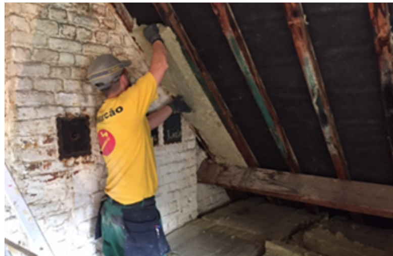
Herplaatsing van isolatie in minerale wol afkomstig van de binnenwanden van een kantoorgebouw in Brussel (ONSS)
