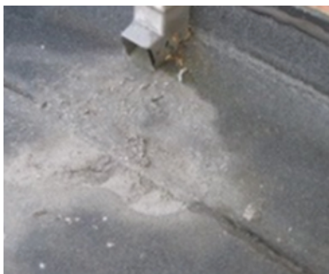
Voorbeeld van afzetting van asbesthoudend materiaal onderaan een regenpijp afkomstig van een asbesthoudende dakbedekking (fotostudiedag OVAM, 17/4/2018, presentatie Sven De Mulder "Asbestdaken veilig verwijderen",
