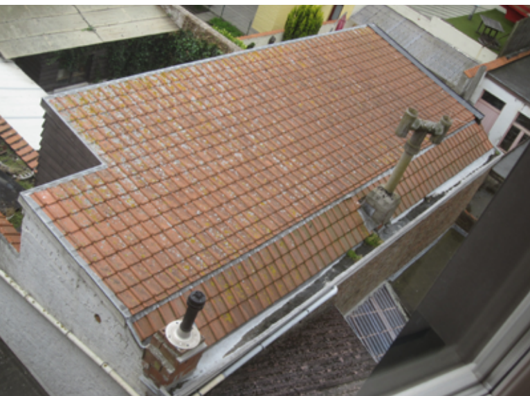
Voorbeeld van korstmossen op een flauw hellend dakvlak met dakpannen (bemerkt: dit dakvlak is lager dan de toegelaten dakhelling voor dit type dakbedekking)
