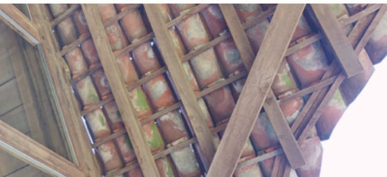
Voorbeeld van toepassing van recuperatiepannen (Vlaamse pannen) op een gebouw uit 1741, herbouwd op KampC in Westerlo; bemerk de gereduceerde neerslagdichtheid van de dakbedekking omwille van de geringere maatvastheid van de pannen; de rol van het onderdak wordt dus zeer belangrijk.
